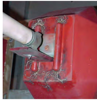
变压器潜在漏电造成的放电现象
