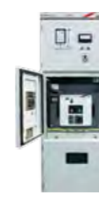
智能真空断路器和开关柜
