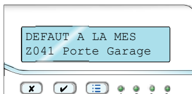
Figure 6. l'afficheur indique une zone en défaut
