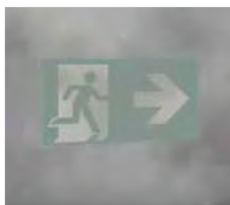
Señal de emergencia mal iluminada
