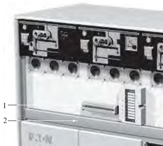
图5-1：含线槽和接线端子的二次室
