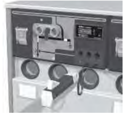
图33: 使用电压检测器手动测试室
