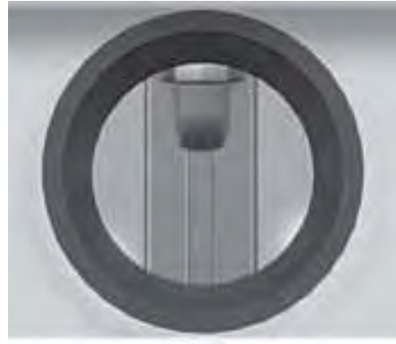
图21: 隔离开关在母线位置
