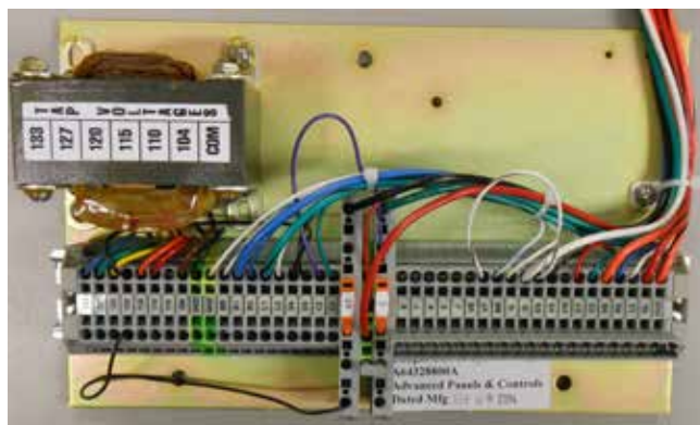
Figura 10. Tablero trasero de control monofásico CL-7 típico.
