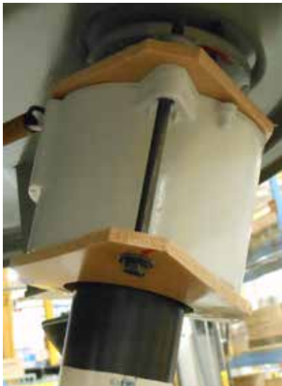
Figura 18. Transformador de corriente montado en bujes internos.
