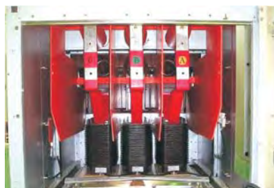
宽敞的电缆室空间
