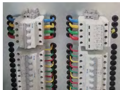
宽敞的布线空间, 带250A中性排
