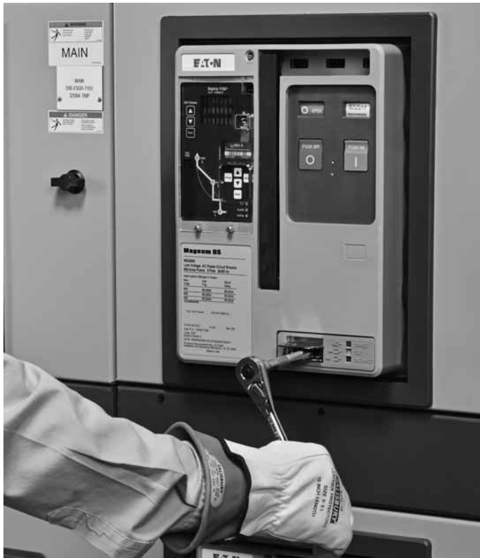
Levering Magnum DS breaker
