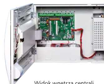
Widok wnętrza centrali
