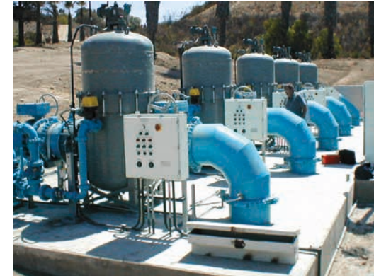
Cinq filtres 24" modèle 2596 d'Eaton avec lavage à contre-courant équipent les pompes d'un site d'épuration d'eau potable.
