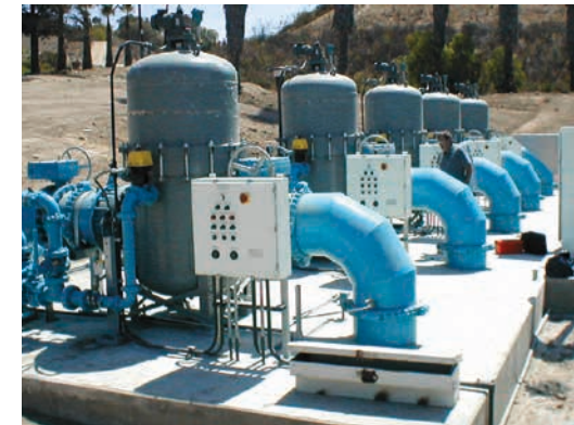
Fünf Siebkorbfilter der Serie 2596 von Eaton mit 24 Zoll und Pumpen zur Unterstützung bei der Rückspülung in einer Trinkwasseraufbereitungsanlage.
