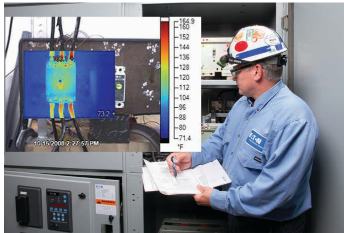
Figure 4. La thermographie infrarouge fournit des informations utiles sur l'état d'un disjoncteur.
