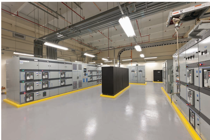
Figure 1. Disjoncteurs alimentant des équipements critiques au centre de données Eaton, à Bluegrass au Kentucky.
