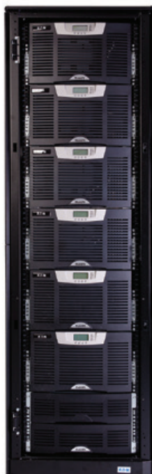
BladeUPS dans un bâti (60 kW, N+1 redondant)
