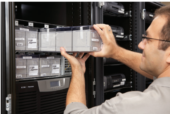
Le personnel des TI peut facilement remplacer les modules de batterie.
