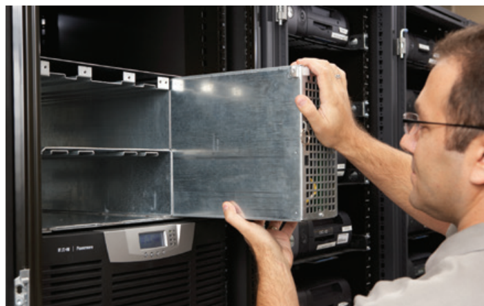
Le personnel des TI peut facilement installer des modules électroniques.
