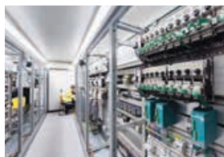
Le poste de contrôle et la technologie électronique ont été livrés dans un conteneur pour que le projet de modernisation de l'opération de concassage puisse être achevé aussi rapidement et aisément que possible.
