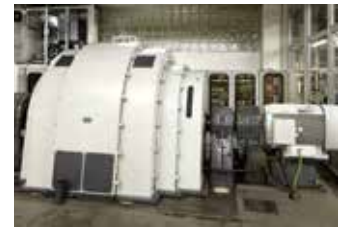
Der Stoßgenerator im Prüflabor von I 2 PS, rechts der neue Asynchronmotor, links hinten der offene Schaltschrank mit der Eaton-Antriebslösung
