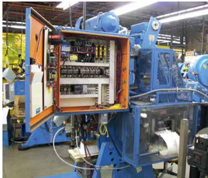
Il pannello di controllo industriale di questa macchina ha 50 kA SCCR contrassegnati sulla targa dati all'interno dell'alloggiamento. La corrente di cortocircuito disponibile è contrassegnata all'esterno.
