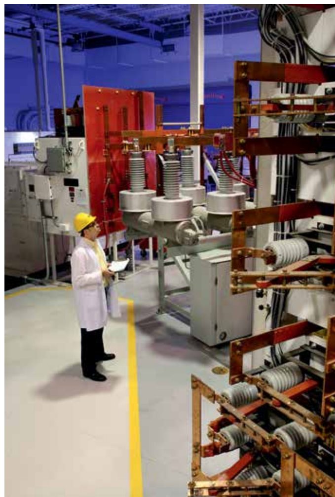
Il centro Paul P. Gubany per la tecnologia ad alta tensione della divisione Bussmann di Eaton è la struttura più completa del settore elettrico per il collaudo e la certificazione della SCCR di dispositivi e apparecchiature. È in grado di eseguire test elettrici fino a 600 volt trifase e 300000 ampere di corrente di cortocircuito in conformità ai requisiti di test ANCE, ANSI, CE, CSA, ETL, IEC e UL.
