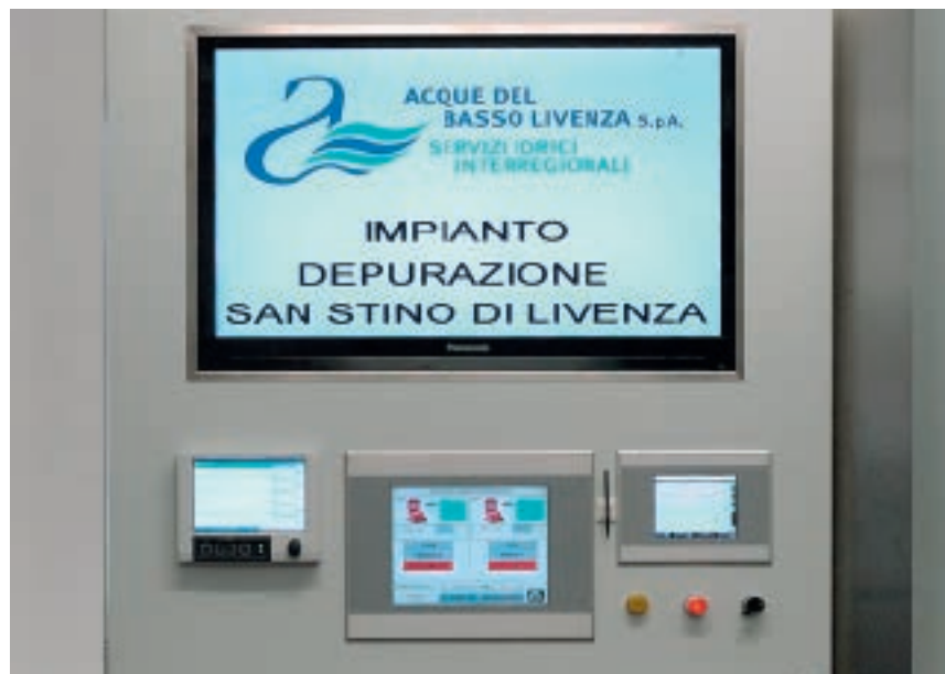
L'impianto è controllato e gestito con un PC industriale e due unità di controllo con display touchscreen, mentre la funzionalità integrata di controllo remoto ne incrementa la continuità di servizio.
