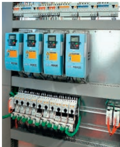
Gli inverter SLX9000, i salvamotori elettronici PKE e SmartWire-DT consentono di risparmiare tempo e spazio.
